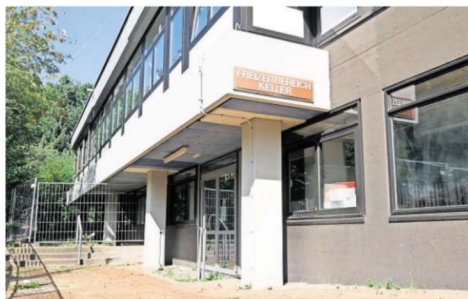
Bis auf Weiteres außer Betrieb: Der Freizeitkeller der Kooperativen Gesamtschule (KGS) Neustadt hat einen Wasserschaden davongetragen.
